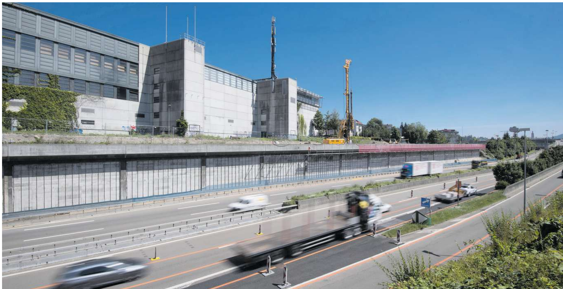
Ein Pfahlbohrgerät dringt durch Erde und Fels. Die 15 bis 20 Meter tiefen Löcher werden mit Beton gefüllt und bilden das Fundament für den Olma-Deckel.
